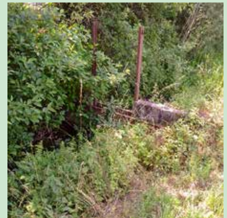
nicht mehr intakte Stauanlage zur Anhebung des Wasserstandes in der 53/38 u.a. zur Be- spannung des Gewässer 53/068
